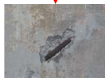
鋼筋腐蝕外露
