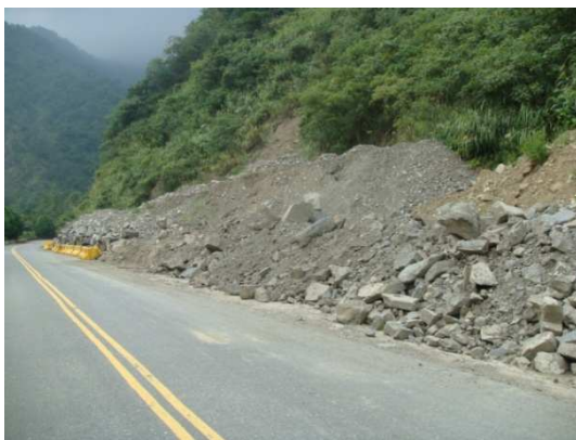
(a)臺 21 線 123.5-124K 土石坍方
