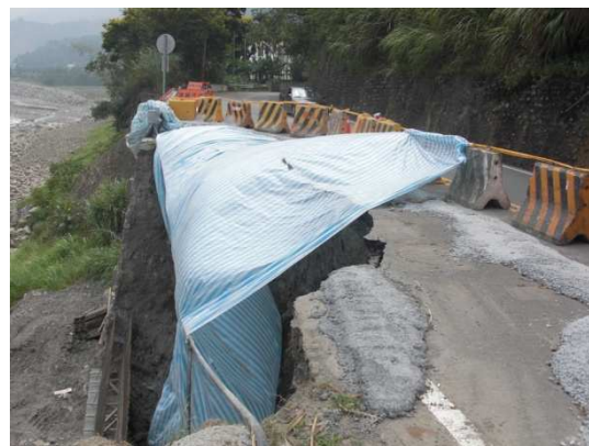
(b)臺 21 線路基流失
