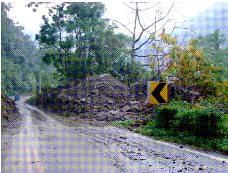
圖 2.28 山區道路災害類型-土石坍方
