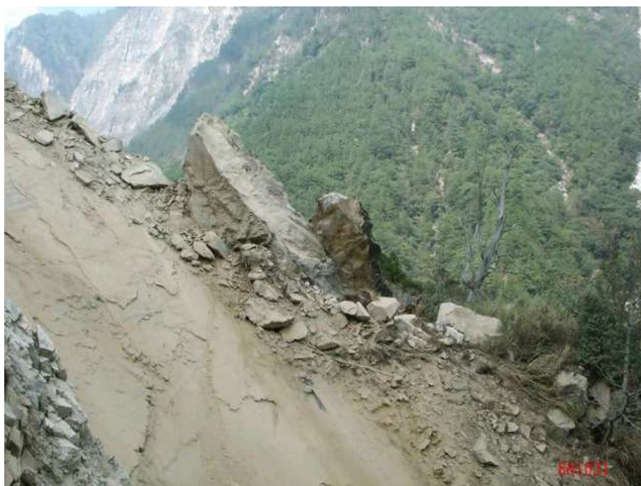
圖 2.30 山區道路災害類型-路基流失
