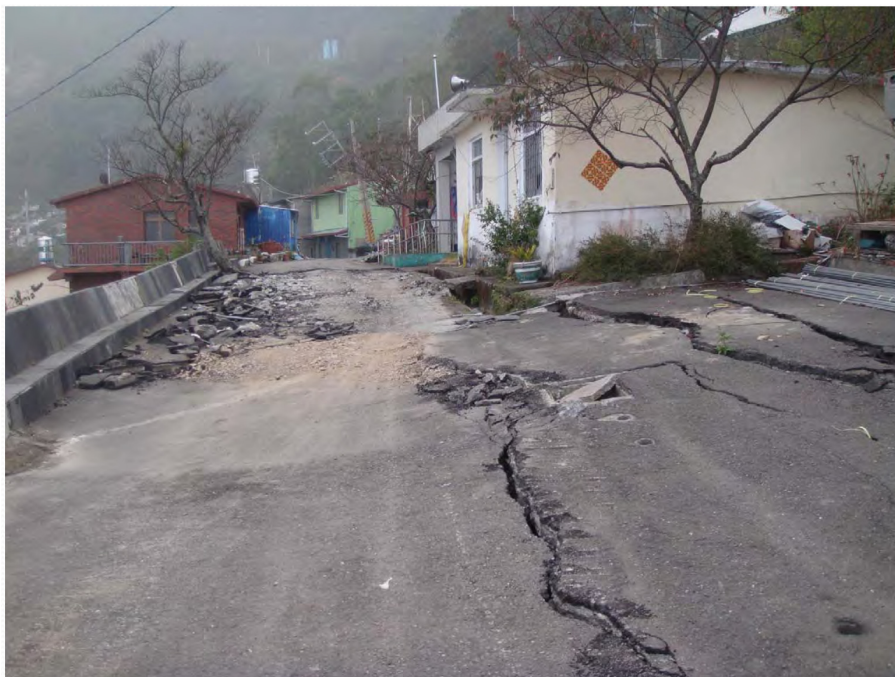
圖 4-8 台 24 線-道路受損
