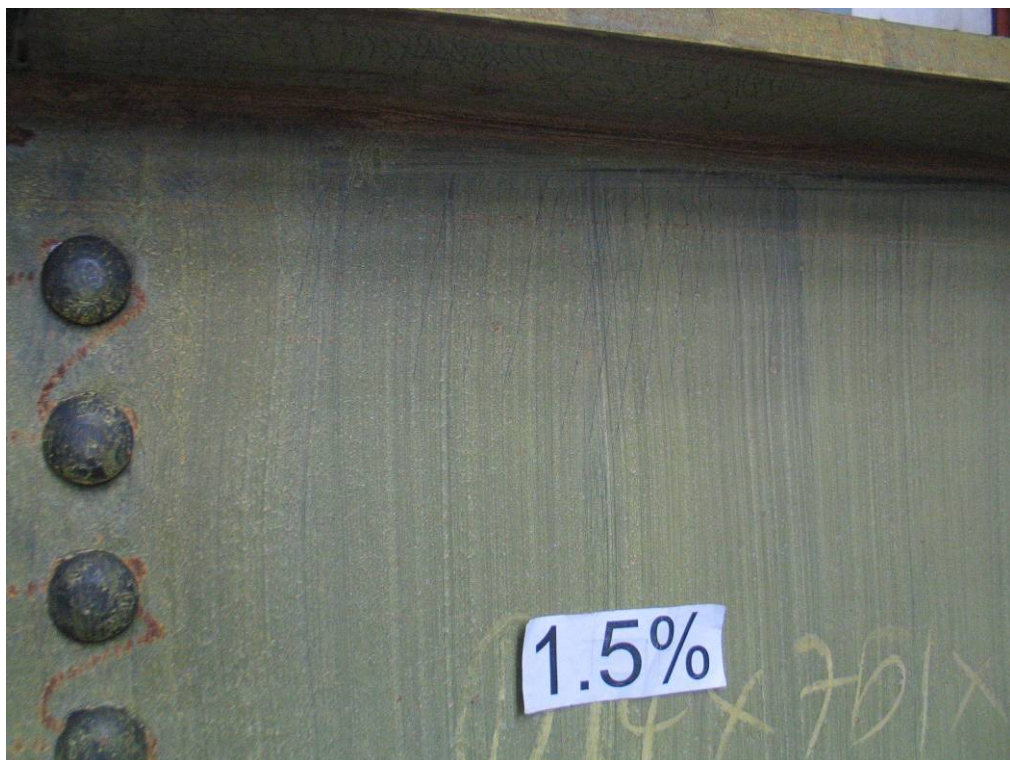
照片 5-4 試體 EC 於尖峰位移角 0.015 弧度時，梁腹板掉漆情況 (資料來源：本研究製作)
