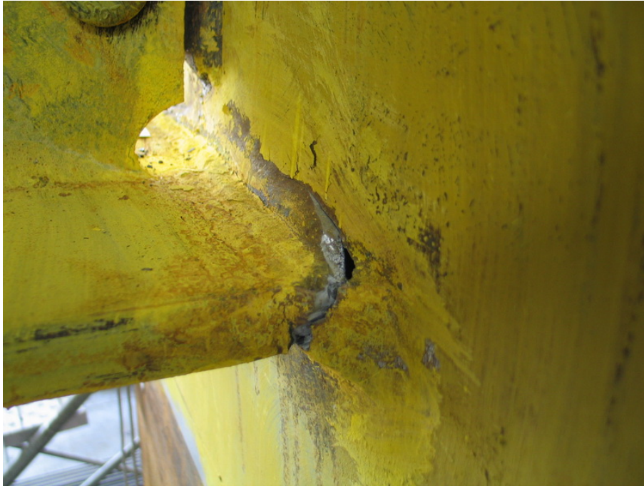
照片 1-1 箱型柱對應於柱內 ESW 銲道位置之柱板受拉破壞情形 (資料來源：林克強等，2010)
