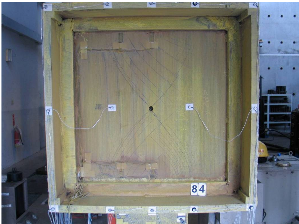
照片 4-10 試體 EC 於試驗位移為 83.7mm 時，柱內隔板之掉漆情況 (資料來源：本研究製作)
