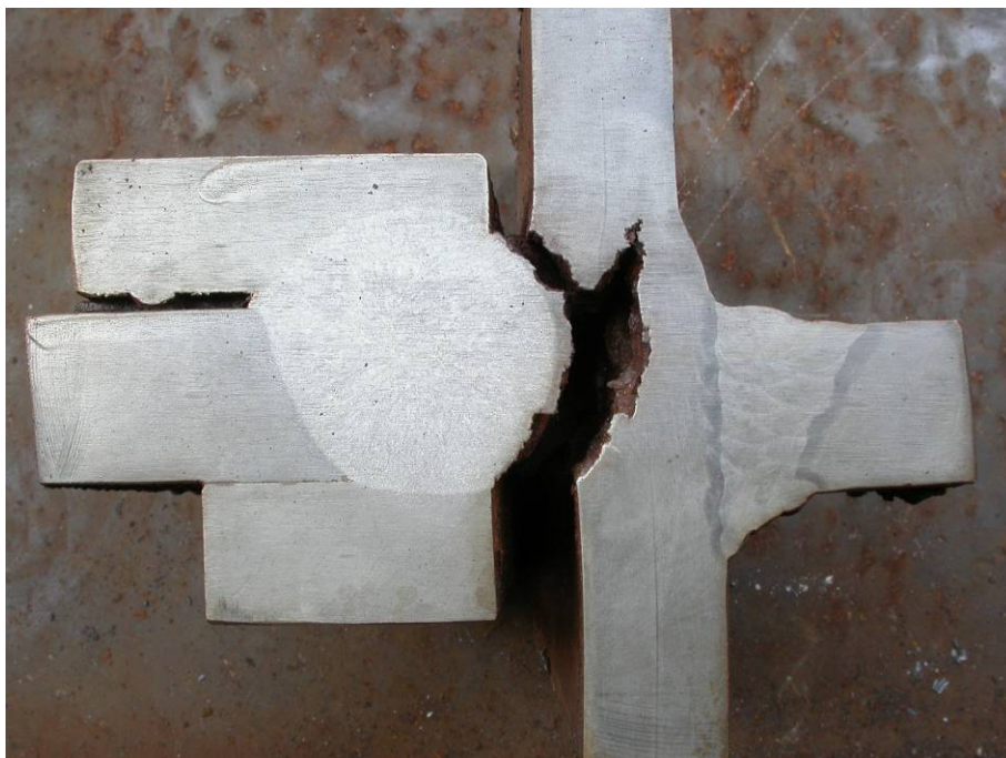
照片 1-2 箱型柱內 ESW 銲道附近熱影響區破壞 (資料來源：林克強等，2010)
