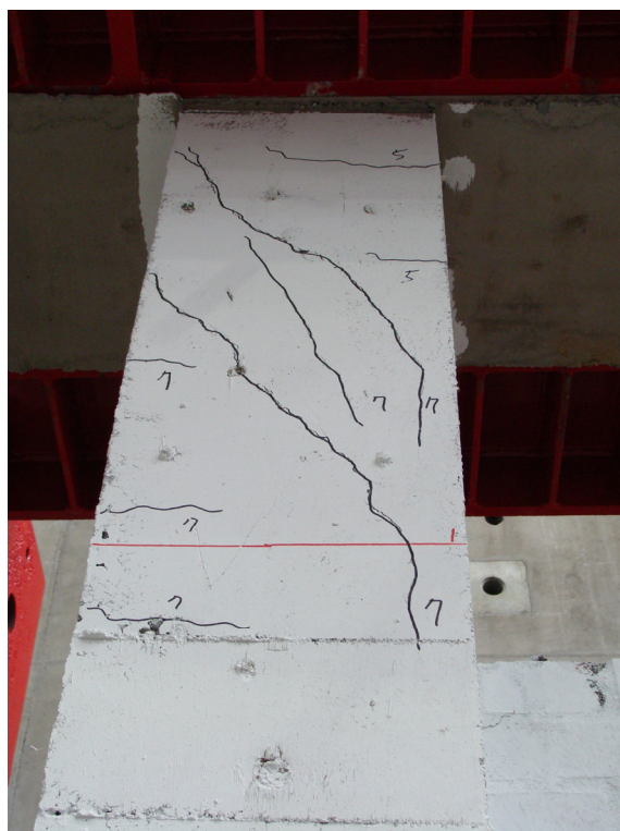
圖 5-18 試體 S3 於位移達 30.5mm 時於短柱處突然增現剪力裂縫 (資料來源：本研究製作)
