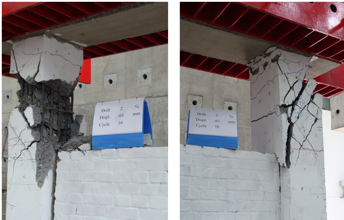
圖 5-20 試體 S3 於位移達 61mm 時短柱處之核心混凝土嚴重損壞 (資料來源：本研究製作)
