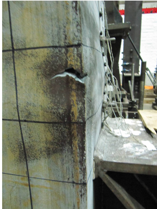
圖 3-16 T48-40-L 試體在側移角 6%時受拉橫裂
