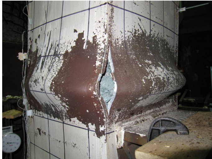
圖 3-7 R40-20 試體在側移角 6%時受壓柱板沿縱向開裂
