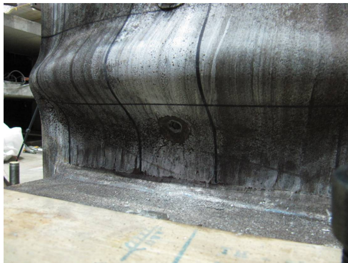
圖 3-23 T40-40-L 試體在側移角 4% 時北面螺桿斷掉 (資料來源：本研究製作)
