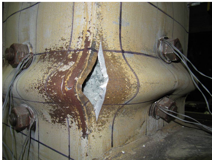
圖 3-19 T40-40-H 試體在側移角 6%時受拉柱板沿橫向開裂
