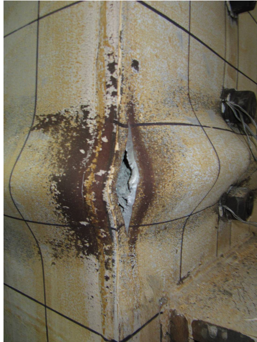
圖 3-11 T48-40-H 試體在側移角 5% 時受壓柱板沿縱向開裂
