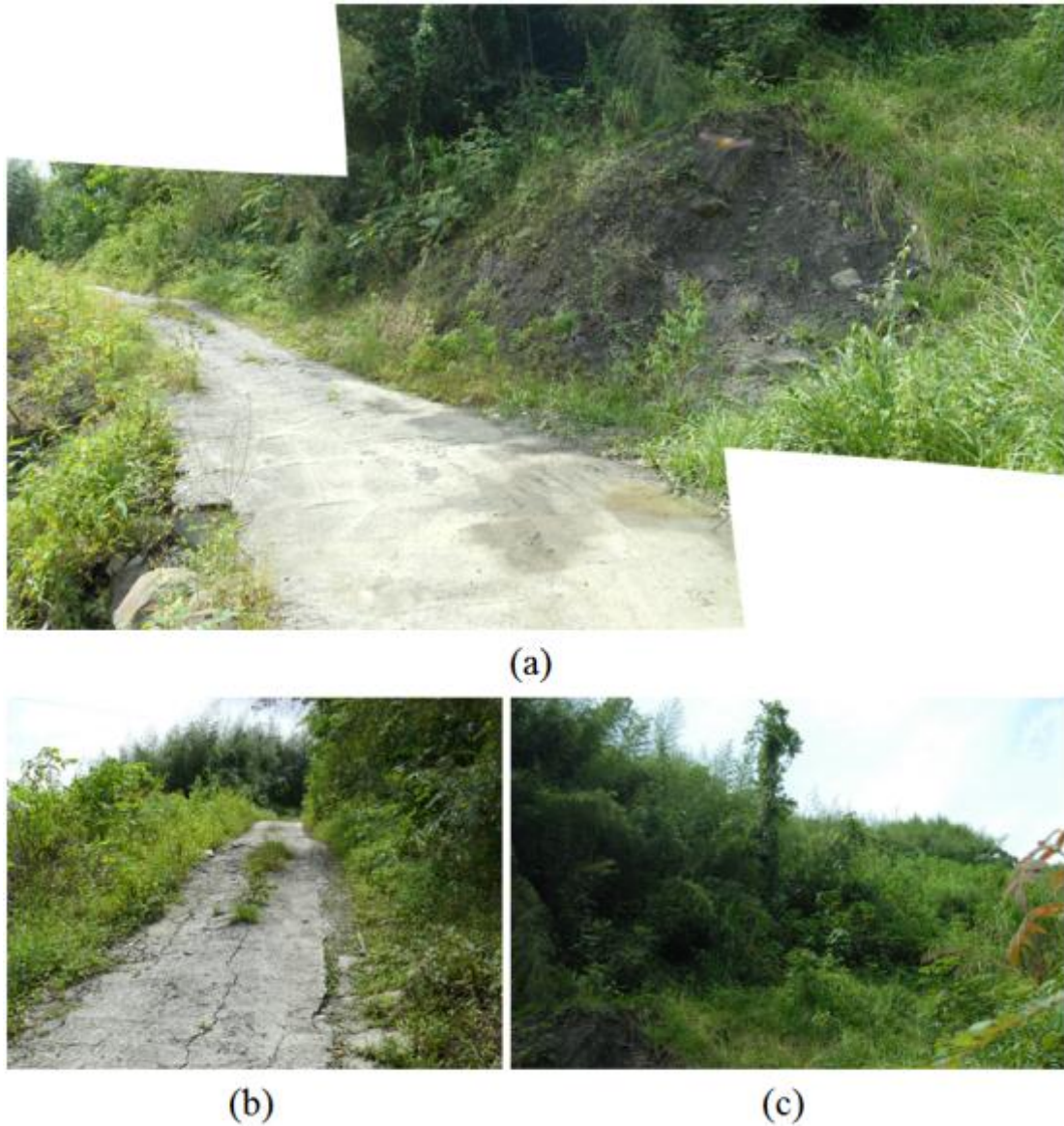
圖 2.23 A09 調查地點之現地概況：(a)坡面崩塌；(b)鄰近崩塌面之道路；(c)崩塌面右側，林相凌亂。
