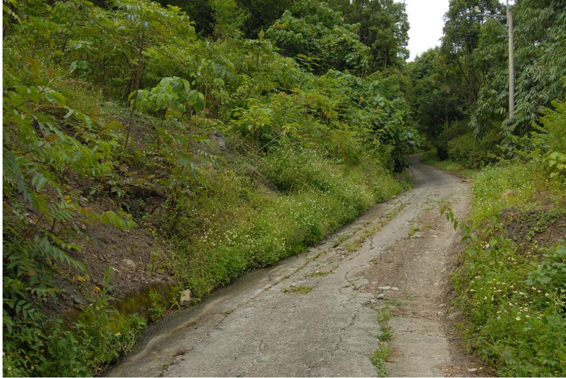
圖 2.25 A12 調查地點之現地概況：道路龜裂陷落。
